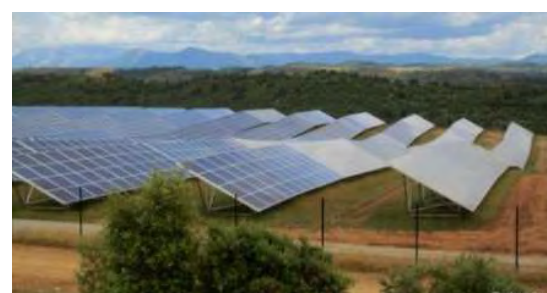
Photographie 1 : Exemple d'installation photovoltaïque au sol
